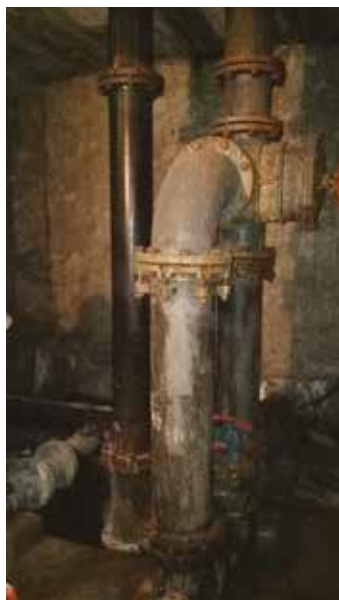
Les anciennes tuyauteries datant des années 1960
