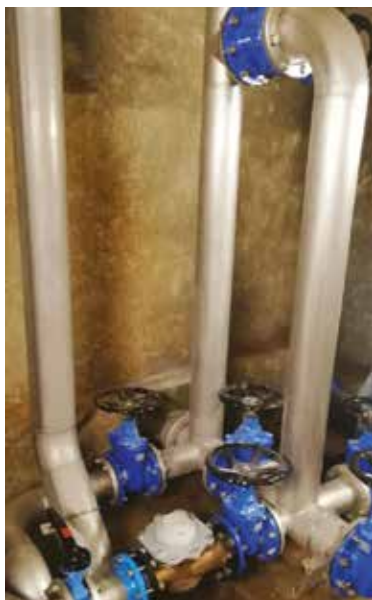
La nouvelle installation avec tuyauterie inox et nouvelles vannes
